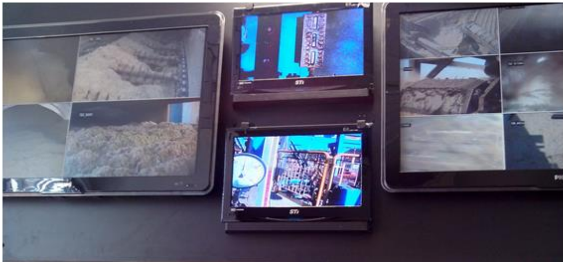
Medição de Nível no Tubulão da Caldeira – Visualização da sala de Controle
